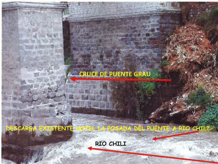
Vista Lateral desde la Avenida La Marina; donde se aprecia el Cruce Faltante por una de las Columnas del Puente Grau y la descarga Actual Existente del Hotel la Posada del Puente directamente al Efluente del Río Chili ocasionando serios problemas de Salubridad.
